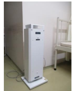
医務室 空気循環式紫外線殺菌機設置
