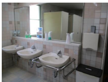
全洗面台出入口に ペーパータオル・消毒液を設置
